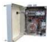
13 Cuadro eléctrico para motor cajón estanco
